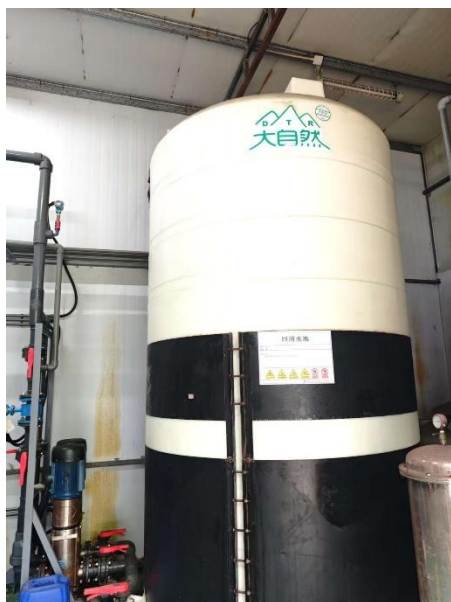
含鎳廢水零排放廢水回收利用系統
