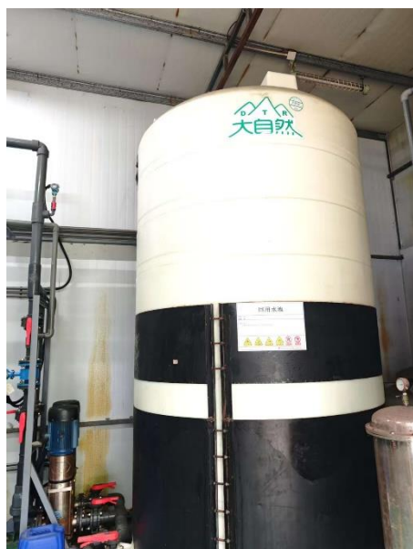
含鎳廢水零排放廢水回收利用系統
